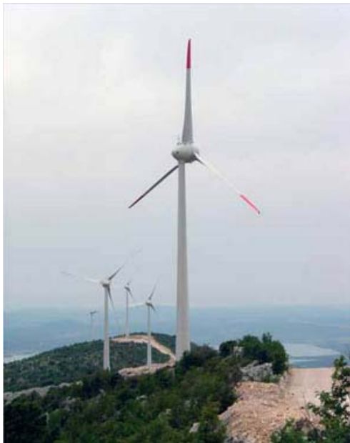
Sustav vjetroelektrana na lokaciji Trtar Krtolin kod Šibenika
